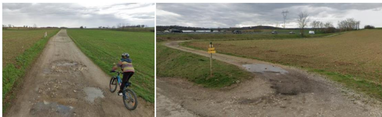
Figure 9 : Chemin agricole à réhabiliter (Source : AVP, Carrefour giratoire et aménagements connexes à Heyrieux, 29/06/2022)
