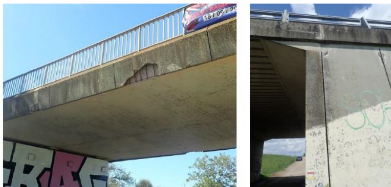
A gauche : initialement peu potentiel pour le gîte de chiroptères mais avec des détériorations au tablier ; à droite : passage inférieur pouvant constituer un gîte anthropique pour chiroptères (Acer campestre)
