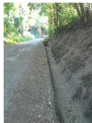
Collecteur d'eau pluviale aménagé
