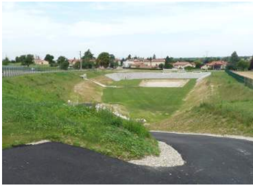
Déversoir d'orage le long de l'avenue Général Leclerc
