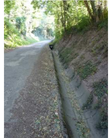
Collecteur d'eau pluviale aménagé
